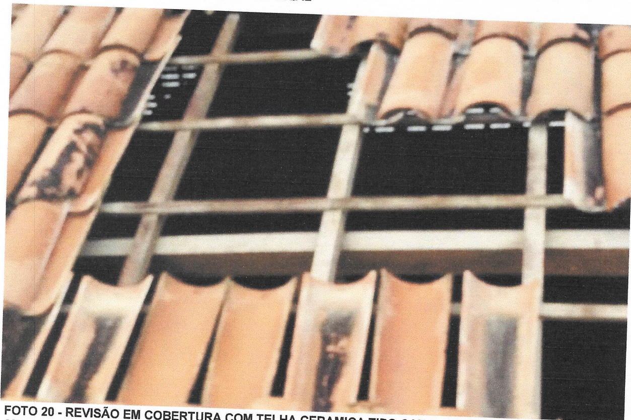
FOTO 19 - REVISÃO EM COBERTURA COM TELHA CERAMICA TIPO CANAL COMUM, ITABAIANA OU SIMILAR, COM REPOSIÇÃO DE 10% DO MATERIAL
