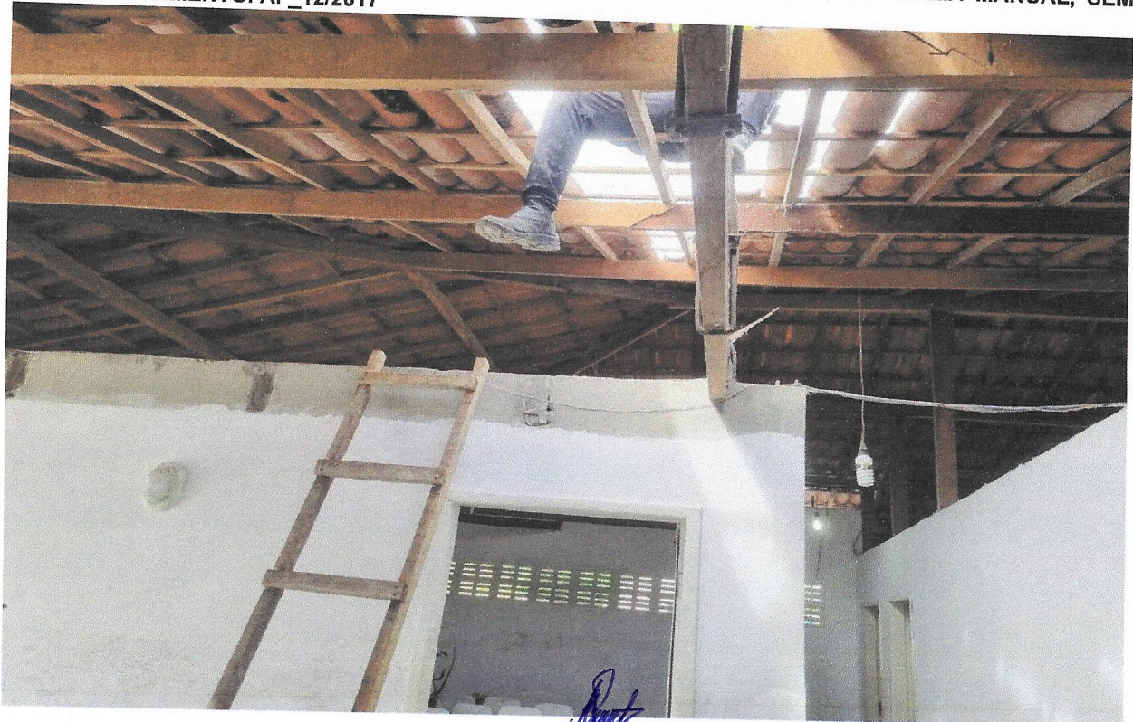
FOTO 06 - REMOÇÃO DE FORROS DE DRYWALL, PVC E FIBROMINERAL, DE FORMA MANUAL, SEM REAPROVEITAMENTO. AF_12/2017
